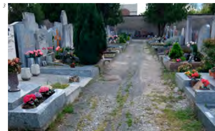
3 - Cimetière de Loyasse à Lyon (69). Cette allée, dont l'enrobé vieillit avec des fissures où poussent des adventices, où creux et bosses gênent la circulation piétonne et créent des flaques après la pluie, sera réhabilitée en ménageant deux bandes enherbées de 50 cm (passage de la tondeuse) le long des sépultures et une bande en béton au centre. © P&C - Sandrine LARRAMENDY 2016
